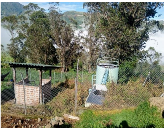
Fotografía 1. Planta de tratamiento de la Cabecera Parroquial
