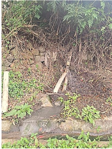
Fotografía 2. Aguas servidas vertidas al canal riego
